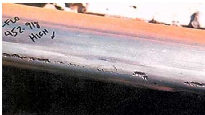
Рис. 1.2. Общий вид головки рельса с трещинами, направленными вдоль оси рельса
